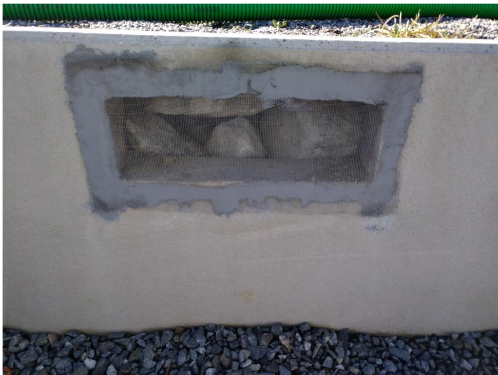
Figur 13 Utlopp bräddning R1 med nät och stenkross.
